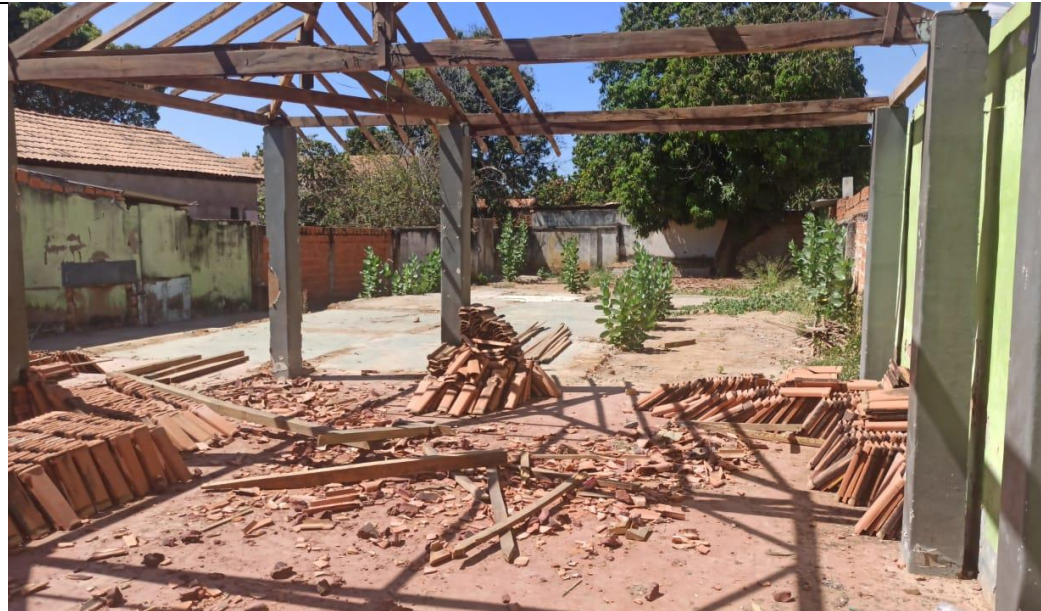
Foto 01 – Local para construção do Espaço Multiuso E.E. Pres. Olegário Maciel Data: 03/08/2022 – Vista geral
